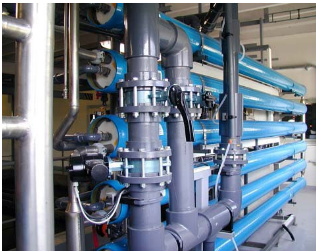
Lepené potrubí v rozvodné stanici
