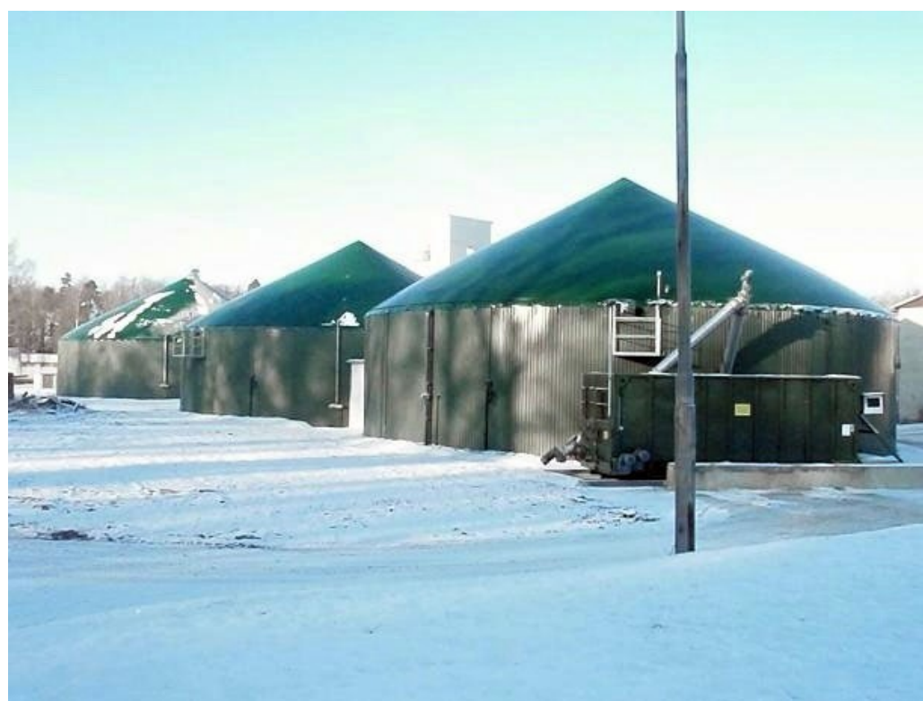
Fermentory bioplynové stanice v Třeboni
